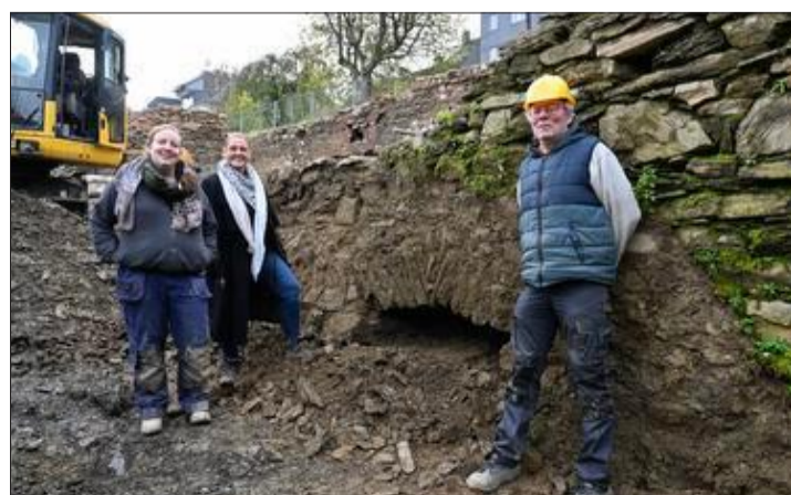
Die jüngste Entdeckung war diese breite Öffnung an der östlichen Außenmauer der Burg.
