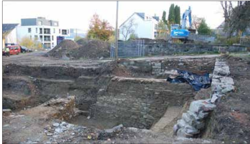
Im Zuge der seit dem 19. Oktober andauernden Grabungsarbeiten auf dem ehemaligen Gelände Pip sind weitere, umfangreiche Mauerreste der dort vermuteten ehemaligen St.Vith'ner Burg freigelegt worden. Fotos: Arno Colaris
